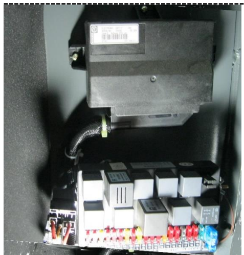
کنترلر الکترونیکی TC که در کنار رله‌ها قرار دارد.
